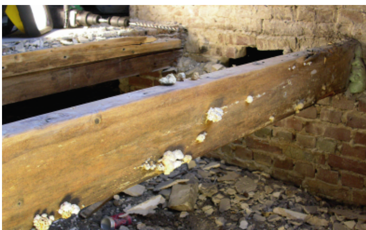
Vruchtlichamen van poriënzwam in een balklaag van een kruipruimte. Deze veroorzaakt bruinrot.
